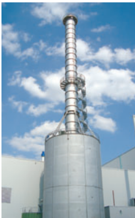
Mokri elektrofilter v URSA tovarni v Nemčiji
