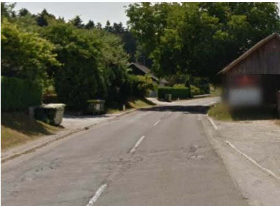
Slika 10: Pogled na objekt v km 9+696, katerega streha sega v prosti profil ceste in je na desni strani na sliki in pogled na vozišč, ki je v zelo slabem stanju
