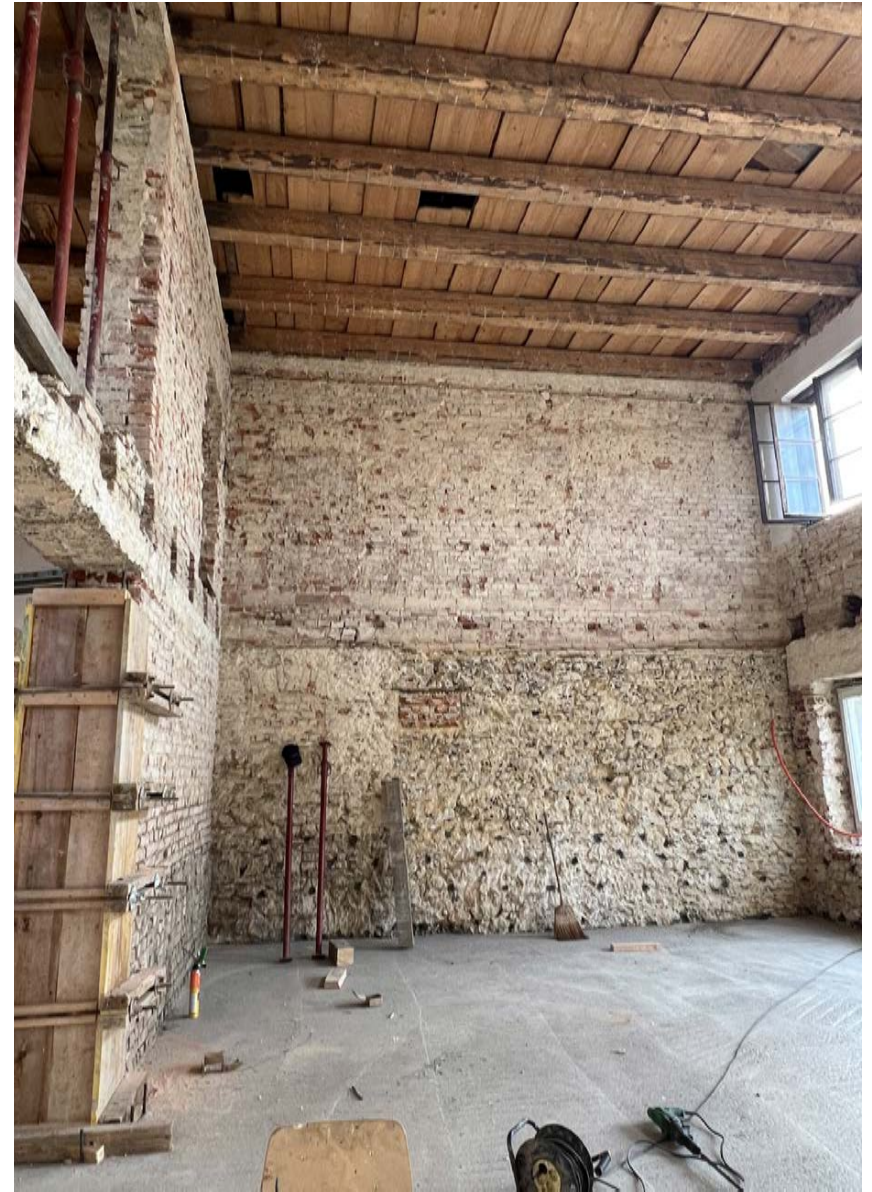
Foto 37: Porušen medetažni leseni strop, spodaj so vidni kamniti zidovi stavbe in zgoraj opečni zid ter zazidana okna in vrata do nekdanjih zunanjih stopnic šole. Vir: KS Gabrje, 2024.
